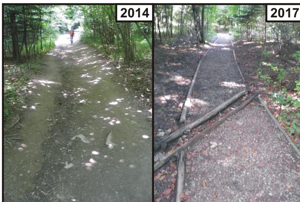
Fot. 16. W wyniku renowacji nawierzchni na znacznej długości badanego odcinka szlaku niebieskiego (Kurnikówka-Istebki) wielkość erozji została ograniczona do minimalnych rozmiarów
